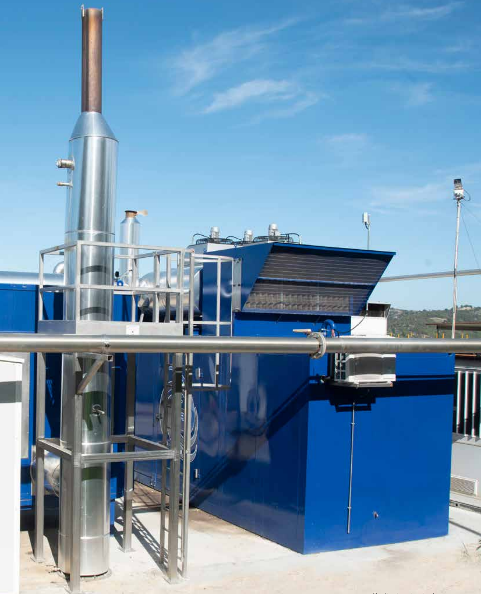
Particolare impianto di trattamento del Biogas dopo modifica autorizzativa.
