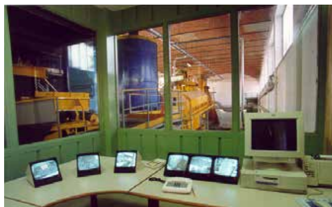
Sala comandi dopo ristrutturazione anni 2000
